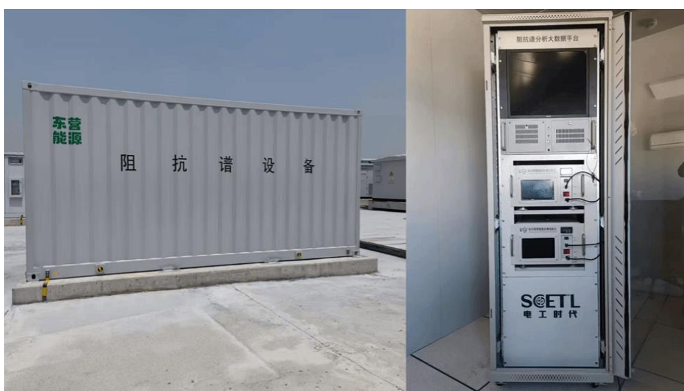
测试设备在调试阶段的现场照片
